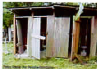
Estado actual de las letrinas en la escuela de Los Potreros
